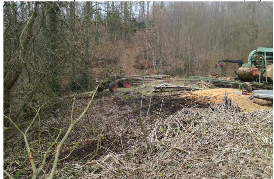
Foto 24: im Bereich der zu verlegenden Säge endet der geplante Erschließungsweg
