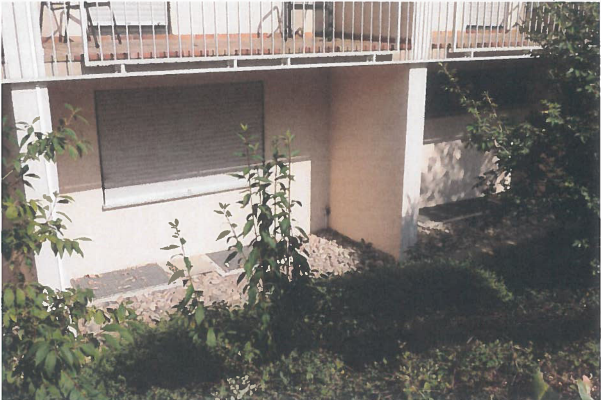
Abbildung 9: Wackelanfüllung unter Balkonen an östlicher Hausseite des nördlichen Gebäudes
